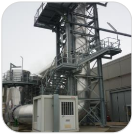
Sistema SME certificato in cabina area sicura
