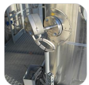
Analisi Certificate QAL1 per Emissioni Camino
