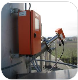
Misura di Portata Ultrasonica a Camino
