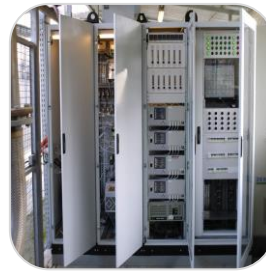
Sistema Quadricanale impianto cogenerazione
