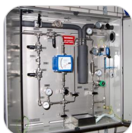
Sistema Condizionamento in cabinet chiuso e termostato
